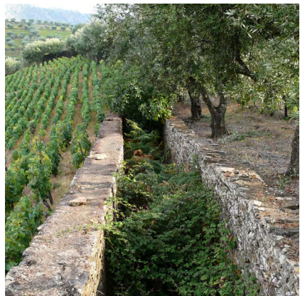
Fig. 13. Condução de águas. Quinta do Bonfim (Pinhão, Alijó), Quinta dos Frades (Folgosa, Armamar) e Quinta Branca (Parada do Bispo, Lamego)
