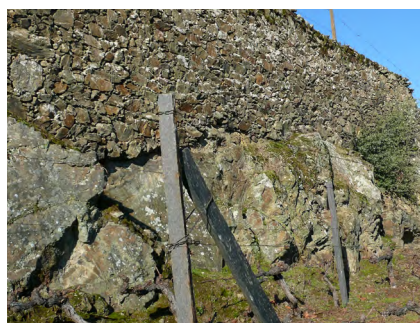
Fig. 10. Muro com incorporação de afloramento. Quinta do Forno, Alvações do Corgo, Santa Marta de Penaguião
